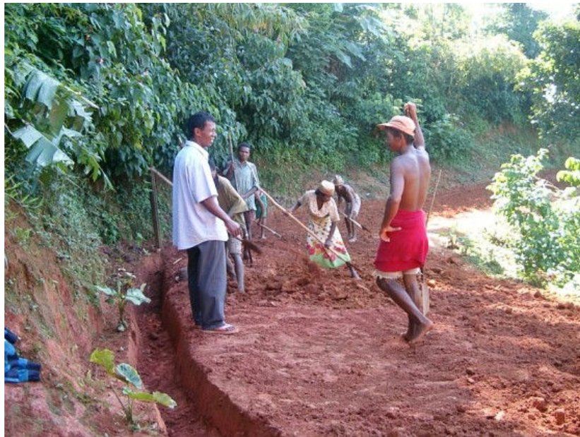
Bild - Strassenbau in Ankaramalaza. Die Arbeiten - auch auf den Feldern - werden ohne Maschinen, mit einfachsten Handwerkzeugen ausgeführt.
